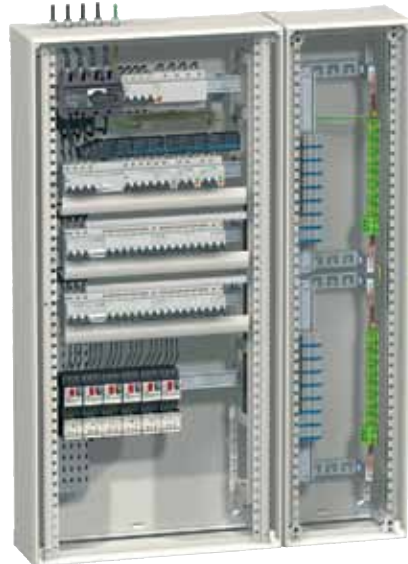
Вводной аппарат в силовом распределительном щите Prisma
