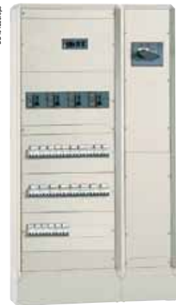
Промежуточный распределительный ЩИТ
